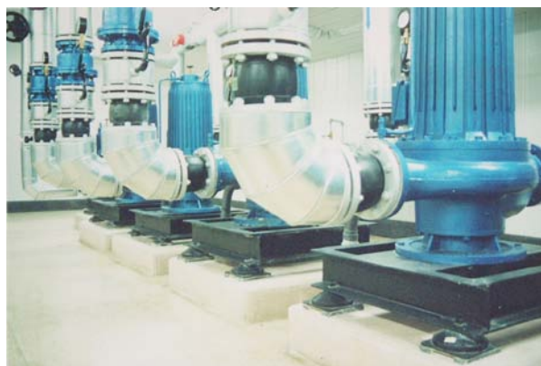
隔振器在水泵隔振中的应用
