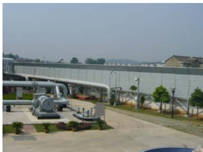
中石化集团江苏省南京石埭桥输油站
