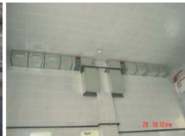
机房内吸声降噪工程
